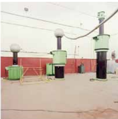
2. Trasformatori monofasi per alte tensioni collegati in cascata Caratteristiche tecniche Tensione nominale primaria: 500 V Tensione nominale secondaria: 250.000 V Potenza nominale: 225 kVA (I unità) ; 150 kVA (II unità); 75 kVA (III unità) Frequenza: 50 Hz Tensione di corto circuito: 4,7%
